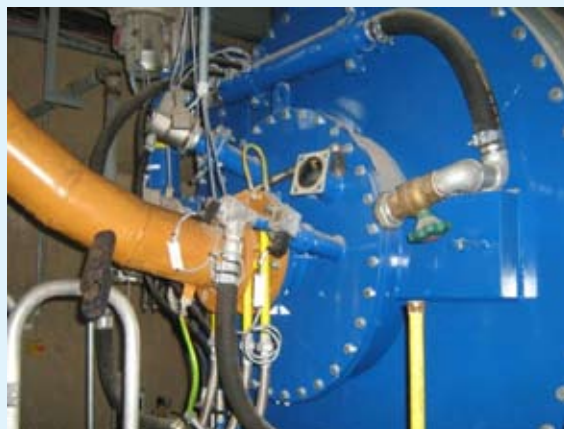
Рис. 3. Генератор горячих газов, работающий на угольной пыли
